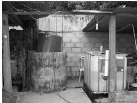
Gambar 6. Digester dan gas holder
